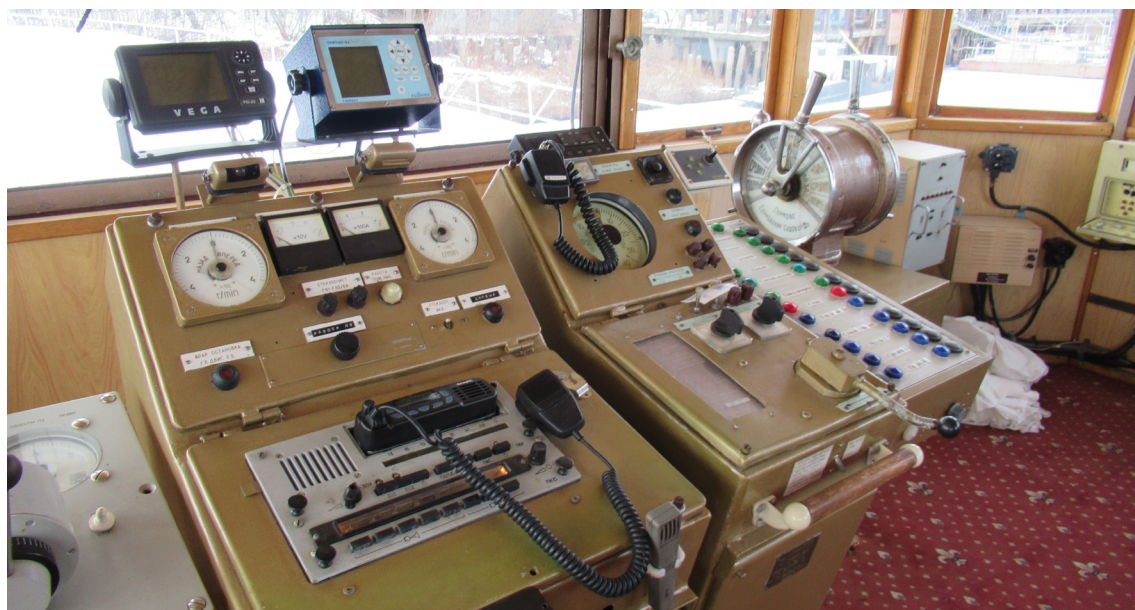
Пульт управления в ходовой рубке теплохода
