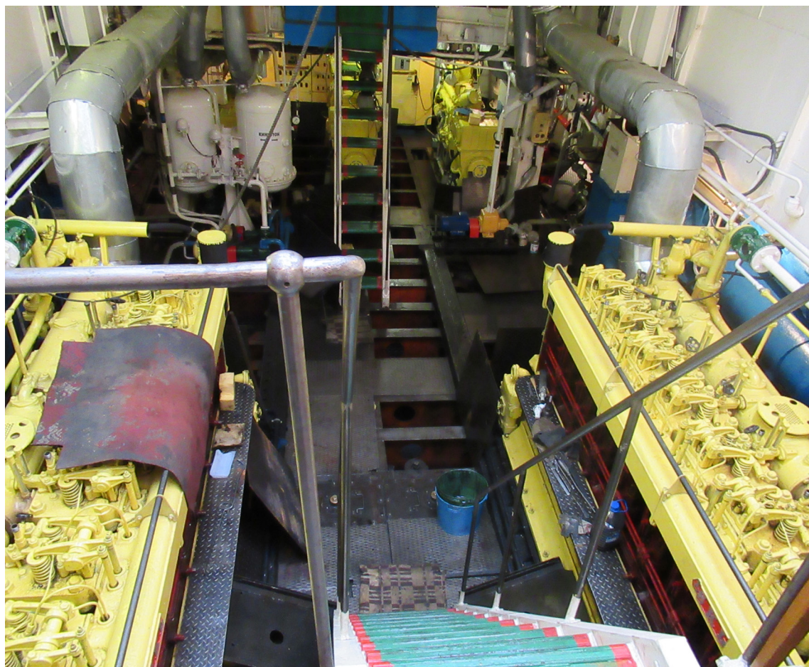
В машинном отделении теплохода
